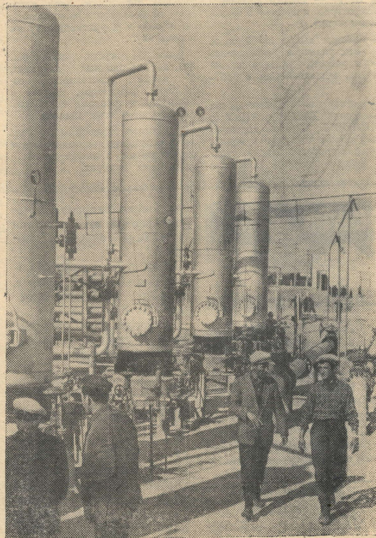
Газосборный пункт на Очакском месторождении.
